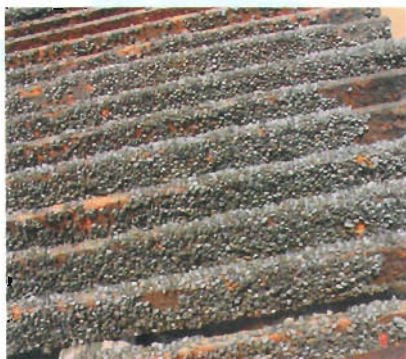
Rejas de central hidroeléctrica
